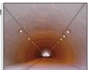
トンネル施設照明 トンネル用 照明設備
