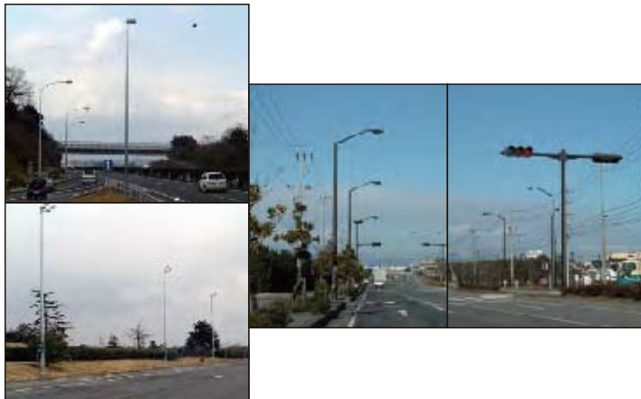
道路施設照明 一般道路、 高速道路、 交差点等の照明
